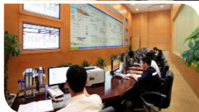
ECC控制中心
